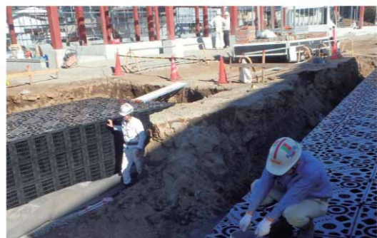
▲ 福祉施設 / 駐車場下・緑地下設置
