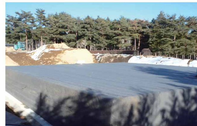
▶ ゴルフ場 / 芝散水用貯水槽
