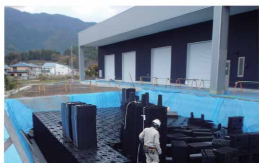
▲ 商業施設 / 普通車駐車場下設置
