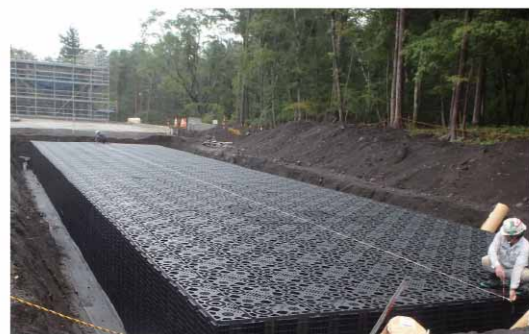
▲ 工場施設 / 普通車駐車場下設置
